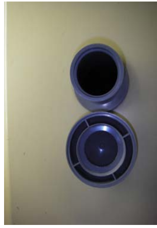
7-22改善後 正常なもの
