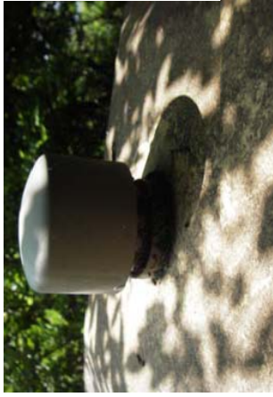
7-17改善前 防虫網が確認できない通気管
