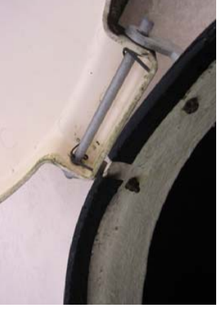
5-22改善前 ハッキン欠落
