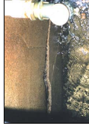
2-24改善前 内壁に亀裂
