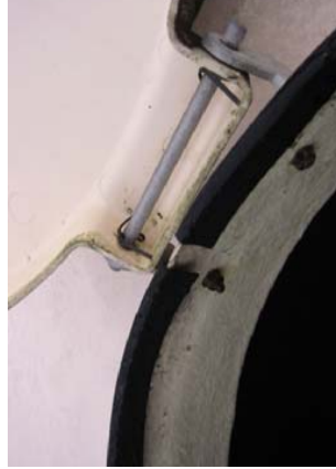
5-12改善前 施錠部品の破損
