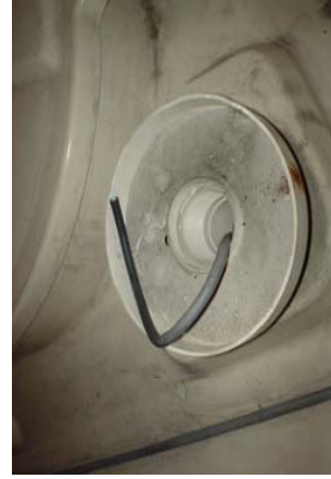
2-12改善前 水位電極(未使用)がなく開放状態
