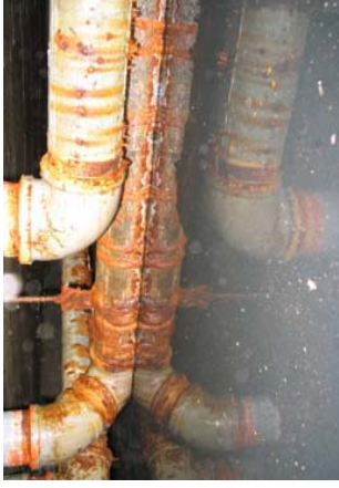
9-3改善前 給水管が汚水槽内を貫通
