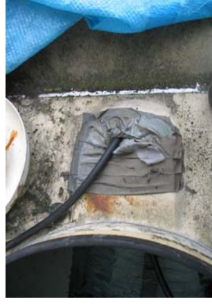
2-21改善前 コート等の挿入部の隙間
