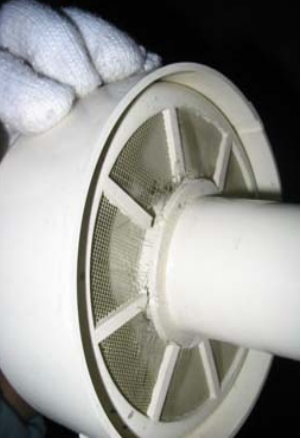
7-15改善前 防虫網の破損
