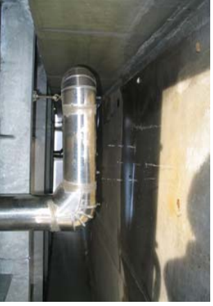
9-4改善前 給水管からの漏水
