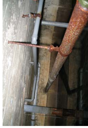
4-18改善前 水槽内部の給水管以外の配管設備
