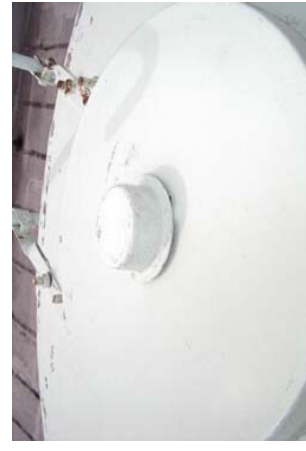
7-10改善前 マンホール部の通気口(埃等が入り易い)
