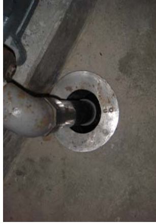
2-18改善前 揚水管挿入部が開放
