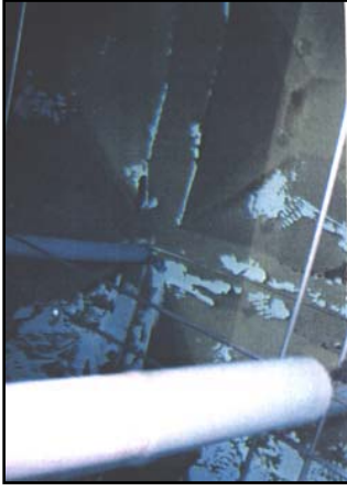
4-25改善前 沈積物(清掃未実施)
