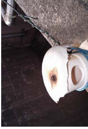
7-5改善前 通気管破損
