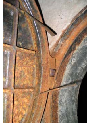
5-15改善前 マンホールの腐食と密閉用のパッキン無
