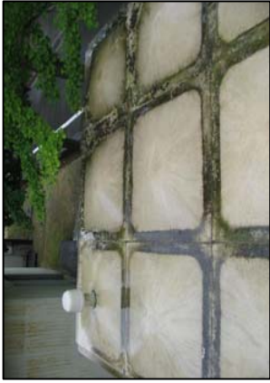
3-1改善前 水槽上部にたまり水あり
