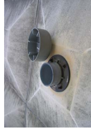
7-23改善後 正常なもの
