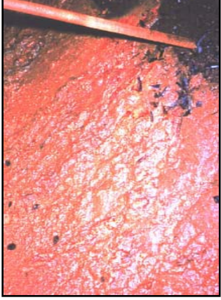
4-26改善前 錆発生
