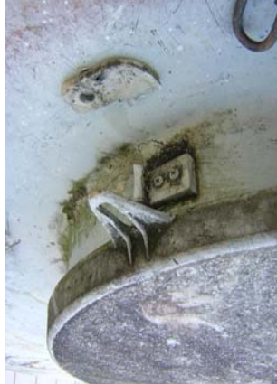
5-16改善前 施錠部品の破損
