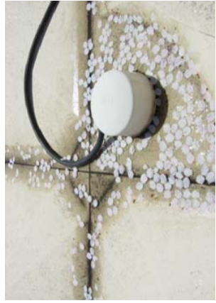
3-6改善前 水槽上部にたまり水あり
