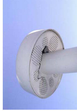
7-7改善前 通気管破損
