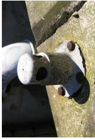
7-6改善前 通気管破損
