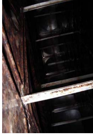
4-9改善前 内部の腐食
