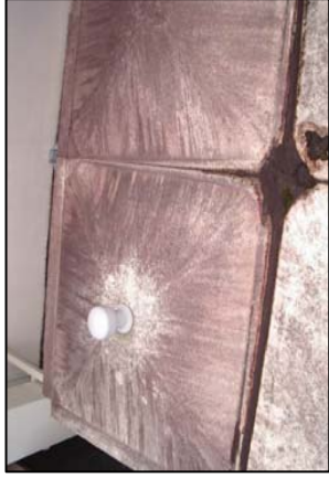
3-2改善前 水槽上部にたまり水あり
