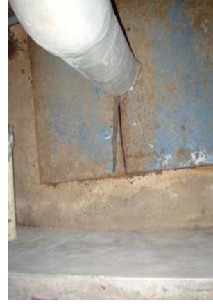
2-19改善前 揚水管挿入部の隙間
