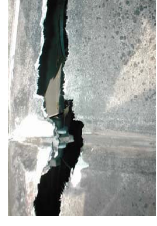
2-23改善前 本体破損
