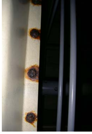
4-16改善前 内部構造物の腐食
