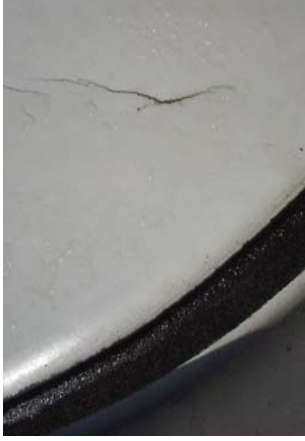
2-5改善前 本体の亀裂
