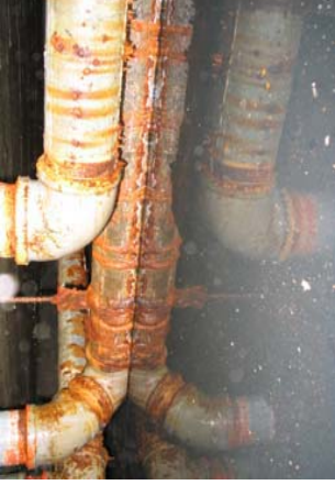
9-3改善前 給水管が汚水槽内を貫通
