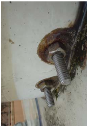
2-9改善前 ボルト取付け部の隙間
