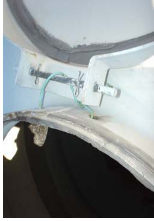
5-3改善前 蝶番破損
