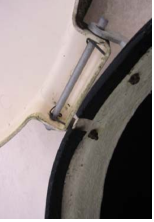
5-22改善前 ハッキン欠落
