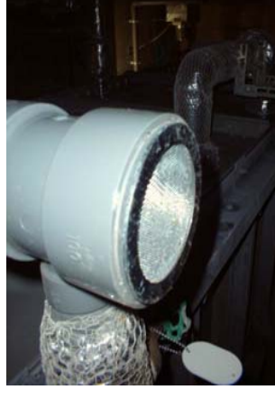
6-10改善後 正常な防虫網の取り付け
