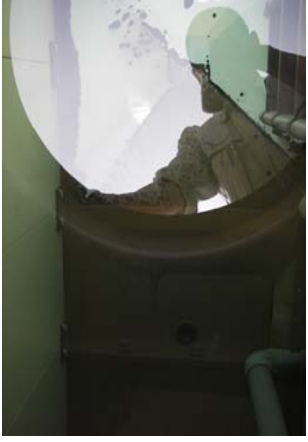
4-2改善前 水槽内部の汚れ、沈積物
