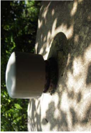
7-17改善前 防虫網が確認できない通気管
