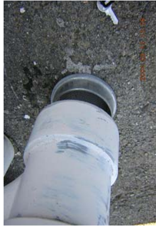
6-8改善前 管端部防虫網の取り付け不良
