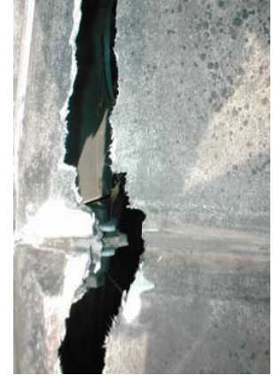
2-23改善前 本体破損
