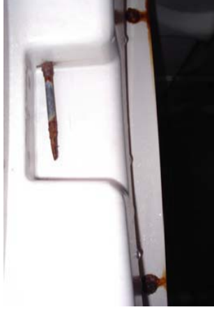
5-5改善前 蝶番軸の腐食、破損
