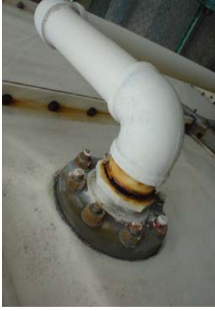
6-5改善前 管接合部の腐食
