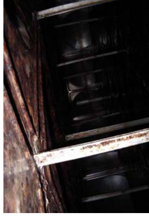
4-9改善前 内部の腐食
