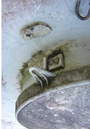
5-12改善前 施錠部品の破損
