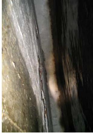
4-14改善前 RC水槽の壁面等の劣化
