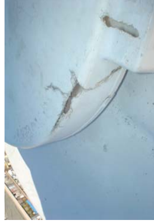
5-26改善後 マンホール部全体にクッション材の取付け 5-27改善前 マンホール部破損
