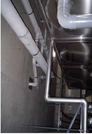
3-5改善前 水槽上部に汚水管
