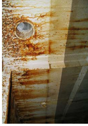
4-10改善前 内部の腐食
