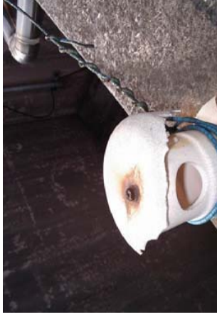
7-5改善前 通気管破損
