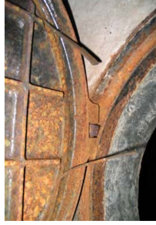
5-11改善前 マンホールの腐食と密閉用のパッキン無
