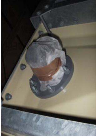
6-2改善前 管端部が横向きのため埃等の混入
