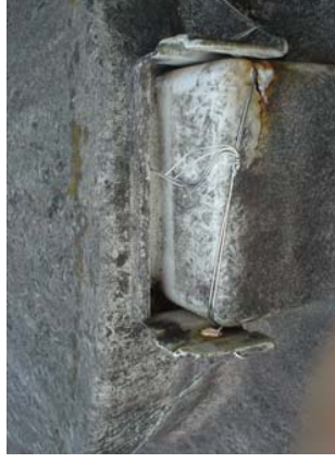
5-4改善前 蝶番破損
