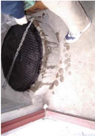
5-32その他 ホンブ室内の施錠の強化(マンホールに錠)
