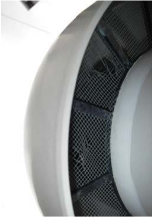
7-13改善前 防虫網の破損
