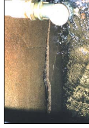
2-24改善前 内壁に亀裂
