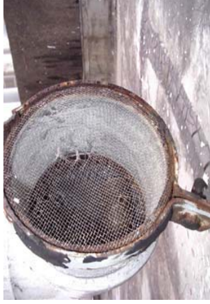
6-7改善前 管端部防虫網の破損
