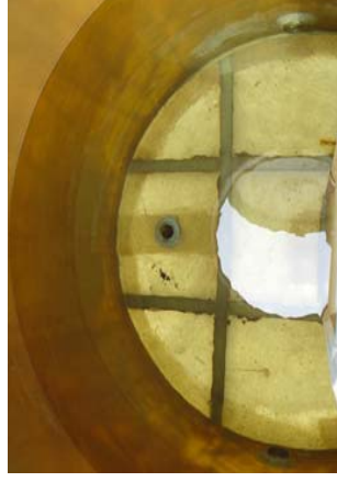
4-11改善前 水槽劣化による光の透過
