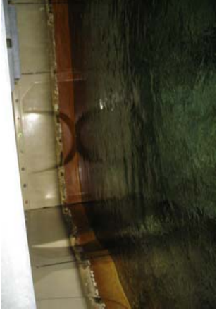
4-1改善前 水槽内部の汚れ
