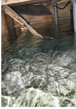
4-7改善前 内部構造物の破損(内部ハネリ)
