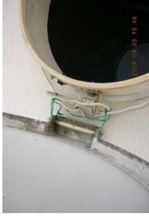
5-6改善前 蝶番破損
