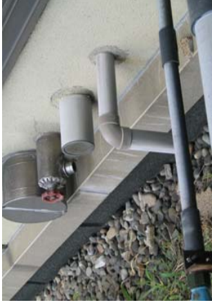
6-1改善前 管端部が横向きのため埃等の混入
