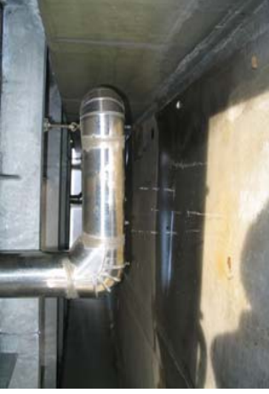
9-4改善前 給水管からの漏水
