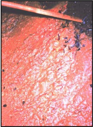
4-26改善前 錆発生
