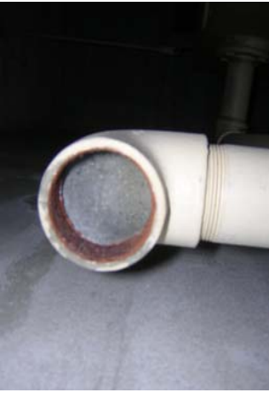
7-1改善前 管端部が横向きのため埃等の混入
