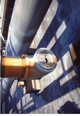
6-6改善前 管端部防虫網の破損
