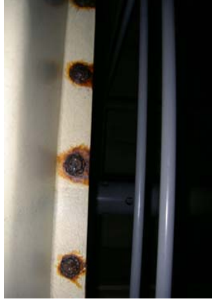
4-16改善前 内部構造物の腐食
