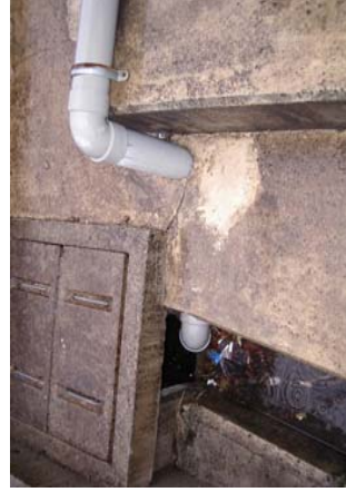
8-2改善前 管端部と排水溝との空間がない
