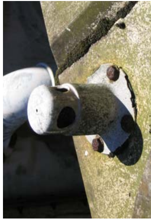
7-6改善前 通気管破損
