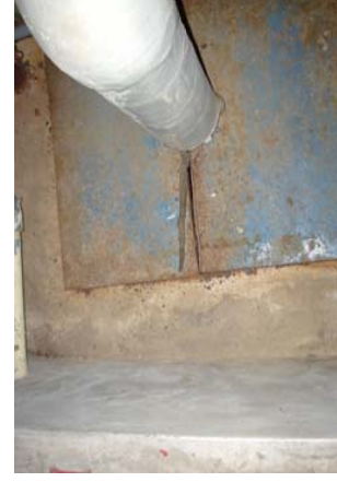
2-19改善前 揚水管挿入部の隙間
