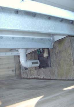
8-1改善前 管端部が排水溝へ直接連結
