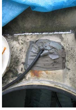
2-21改善前 コート等の挿入部の隙間
