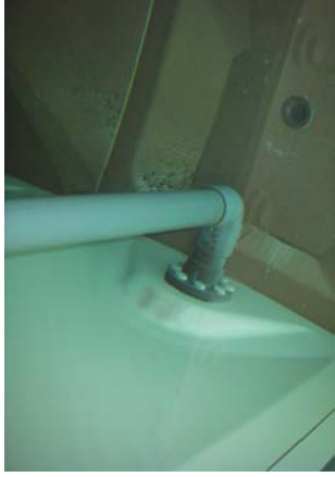
4-3改善前 水槽内部の沈積物
