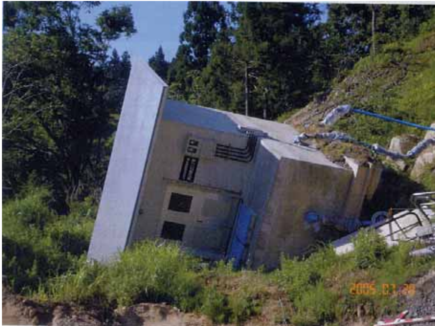
滑落した中継ポンプ場 (旧山古志村簡易水道)
