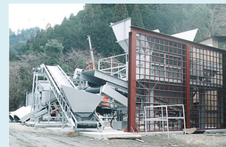
破碎切断施設
