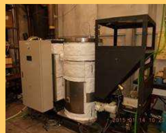
固形燃料を利用する ボイラーの開発
