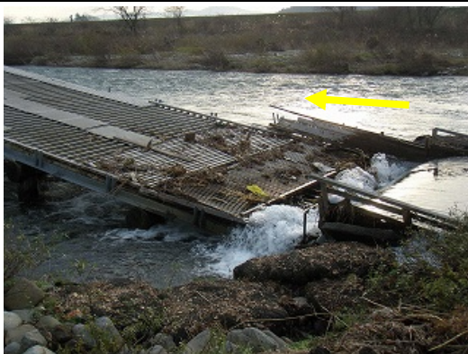
ごみ補足施設（真室川）
