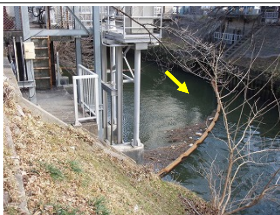
設置中のごみキャッチャー
