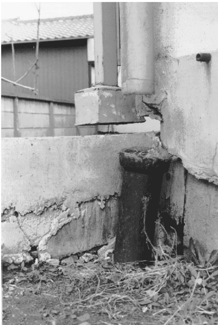
千葉県浦安市の被害事例：建物の抜け上がり状況 http://www.env.go.jp/water/jiban/directory/12chiba/kantouminami/p12-2.html
