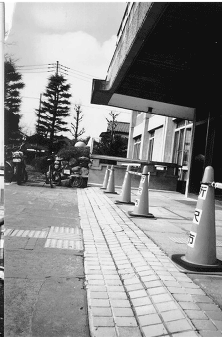
埼玉県所沢市の被害事例：沈下により建物に段差が生じている状況
