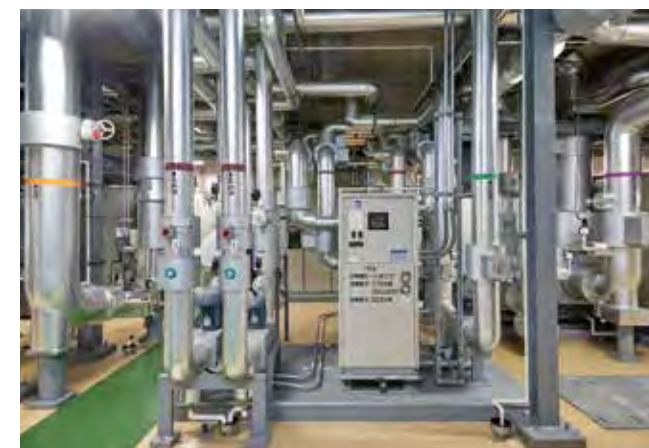
導入された地中熱ヒートポンプ
