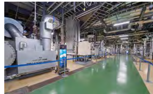
東京スカイツリータウン®地下のメインプラント
