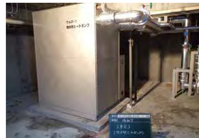
導入した地中熱ヒートポンプ
