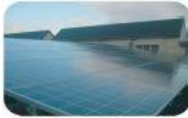
ソーラー発電 (10KW×4基)
