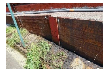
外壁から周囲に油を含んだ水がにじみ出し
