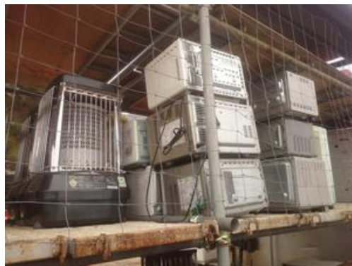
機器の積み上げ例
