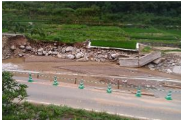
道路片側の崩落 (東峰村鼓の里付近 7/11)
