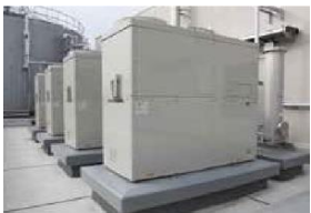
バイオガス発電機
