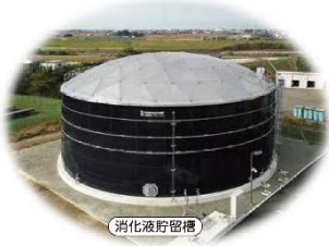
サテライト液肥貯留設備
