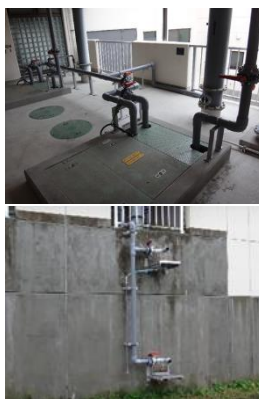
液肥払出槽（既設水槽利用）
