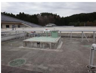
液肥貯留槽（既設水槽利用）
