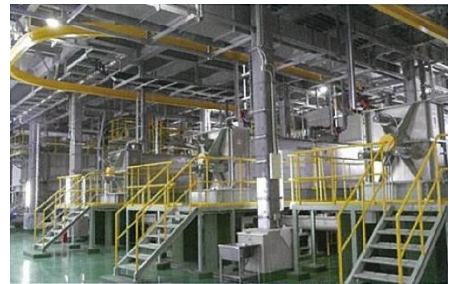
前処理・脱水機室
