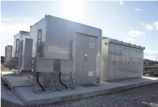
大規模な自立稼働型非常用電源を設置
