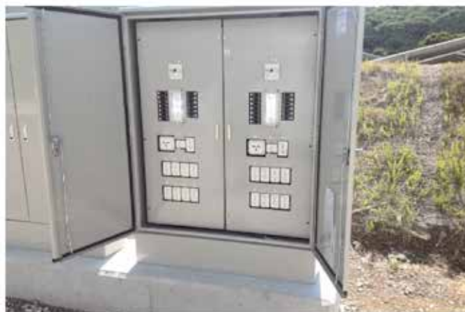
非常用電源を備えて災害時に電力供給が可能
