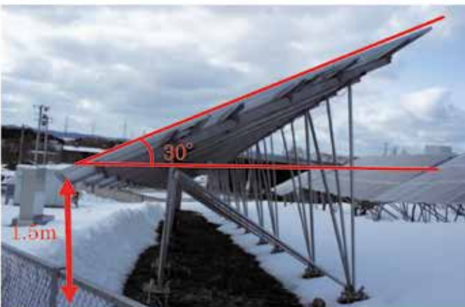
積雪対策としてパネル設置高を最低1.5m、パネル角度を30度で設置
