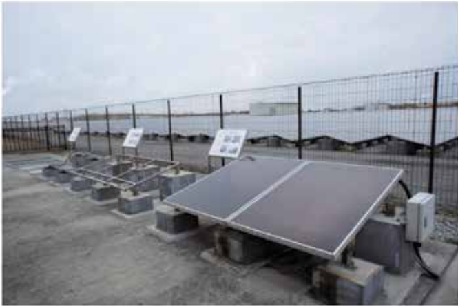
環境教育の一環としてパネルの設置工程を学ぶことができる見学スペースを設置
