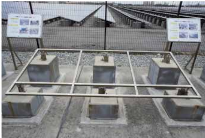
風荷重対策として基礎コンクリートにパネルを直接固定する方式を採用
