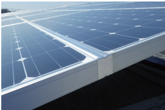
テープの貼付により雨水をアレイ下方向に集水(浸出水抑制策1)
