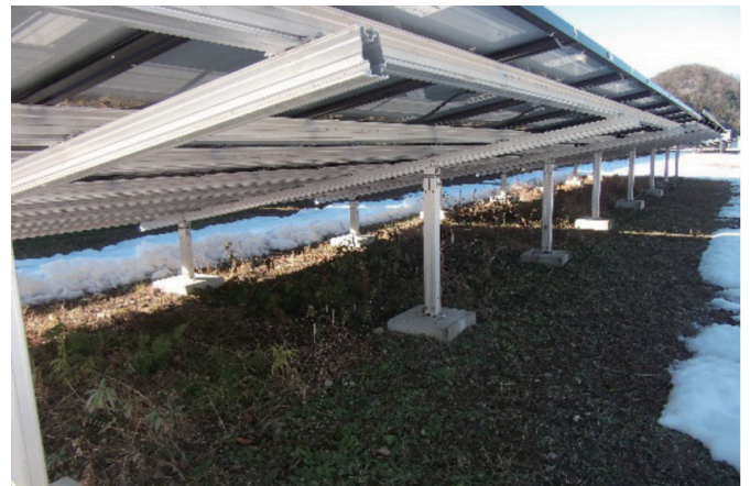
耐食性に優れた架台(構造部材アルミ製、ネジ類ステンレス製)を採用
