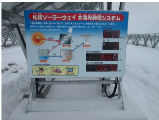
写真 7.2-17 発電表示パネル
