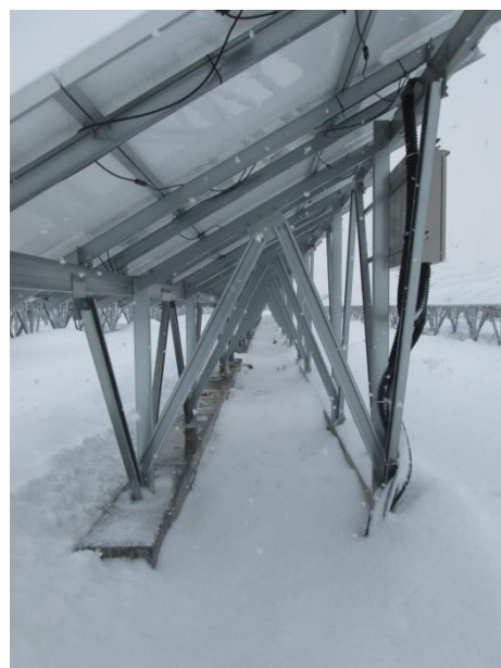
写真 7.2-22 太陽光パネル下部その 2
