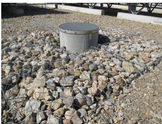
写真7.2-41 処分場ガス抜き管
