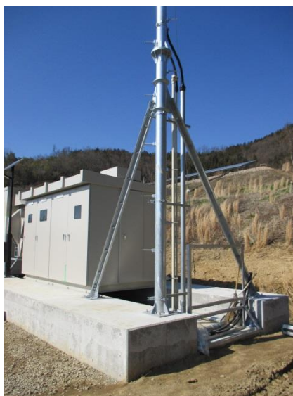
写真7.2-40 パワコン・受変電盤
