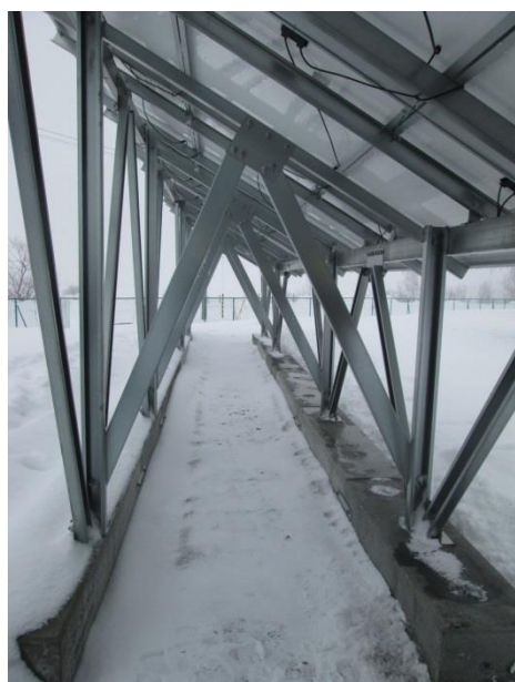
写真 7.2-21 太陽光パネル下部その 1
