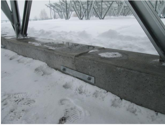
写真 7.2-23 架台基礎連結部分
