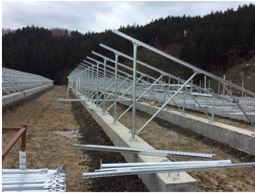
写真7.2-13 架台（バー設置）
