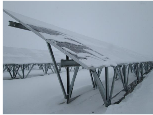
写真 7.2-26 パネルからの落雪
