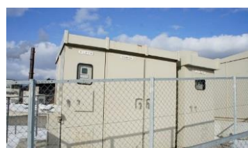
図 非常用電源
