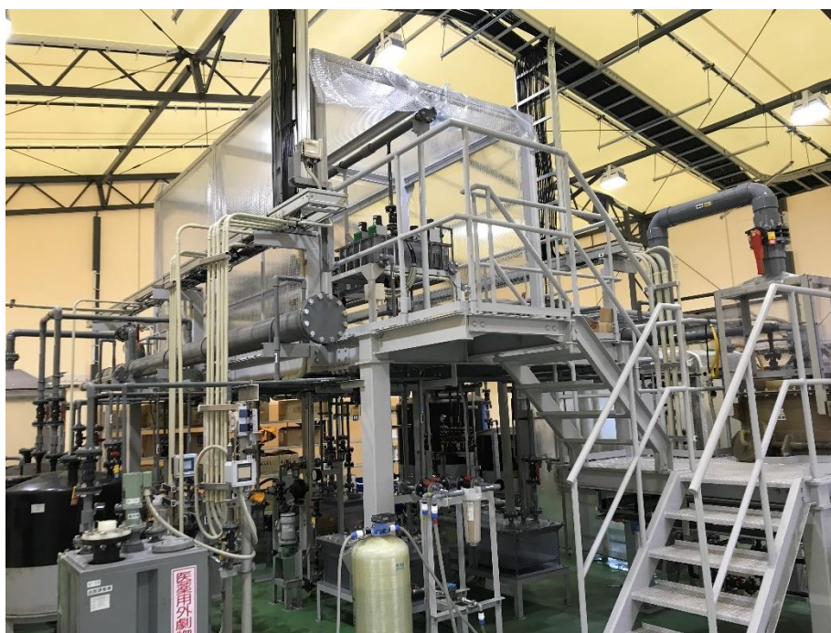
図 3.4.1-2 湿式回収実証試験設備の外観
