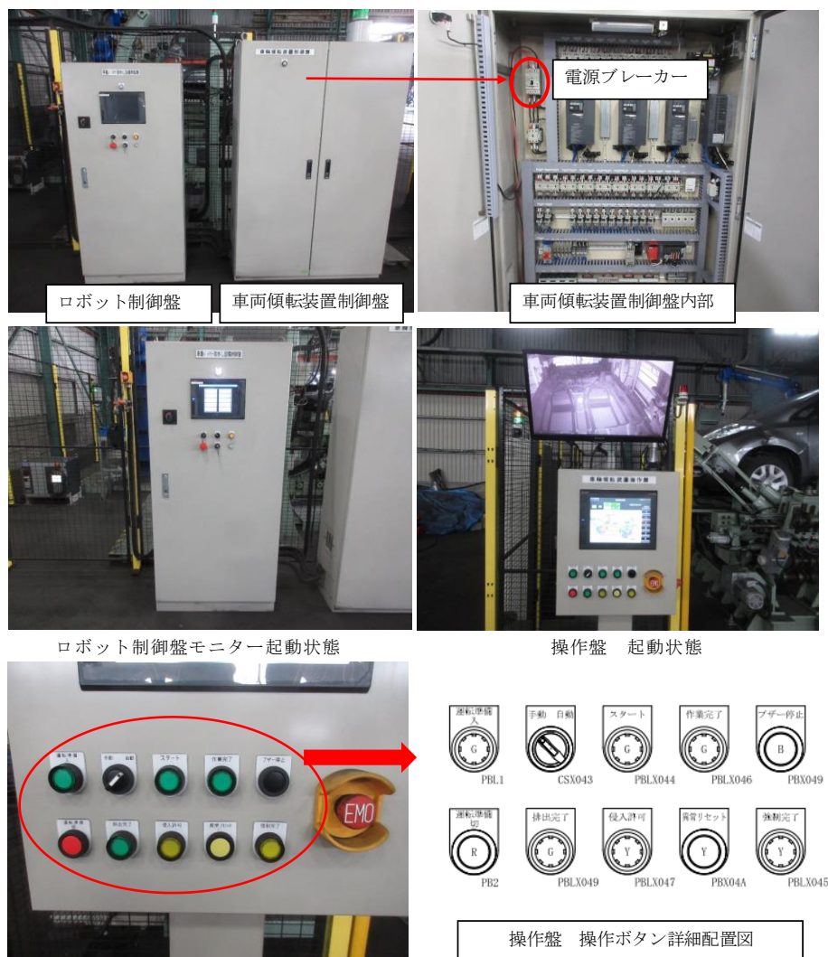
図 3. 1. 1-24 LIB ユニット取り出し自動化装置の制御盤と操作盤及びロボットの制御盤
