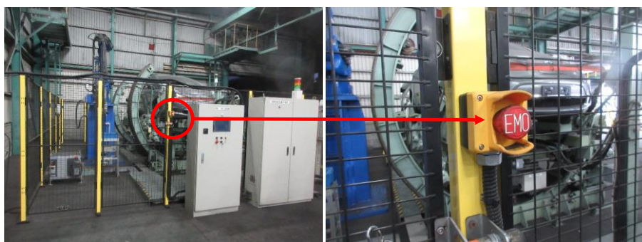
車両傾転装置 制御盤横作業用扉 緊急停止ボタン
