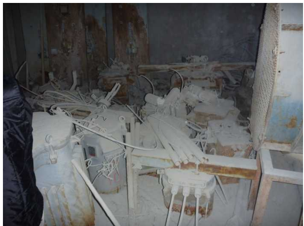
乱雑に放置された微量疑い変圧器類
