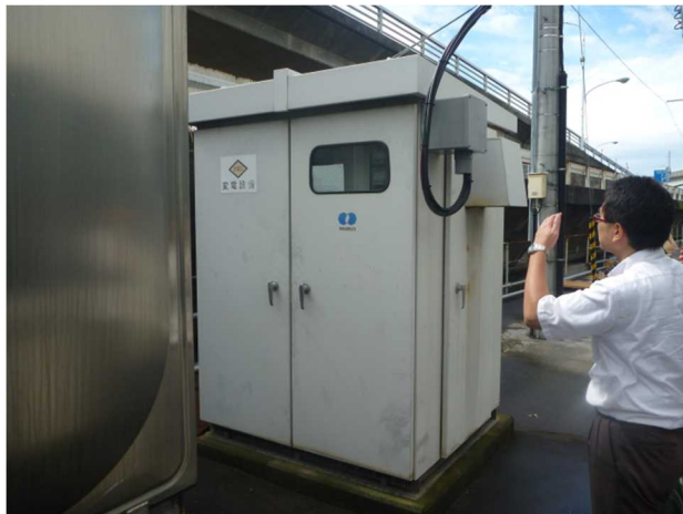
キュービクル外観
