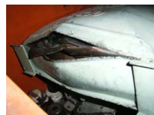
短絡等により破裂・変形や内部素子が炭化したコンデンサ
