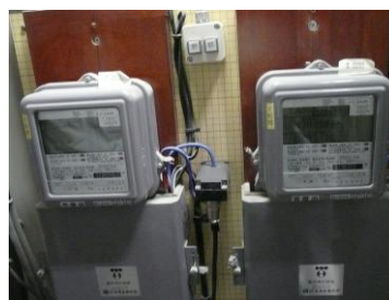
写真2 買電用と売電用電力量計
