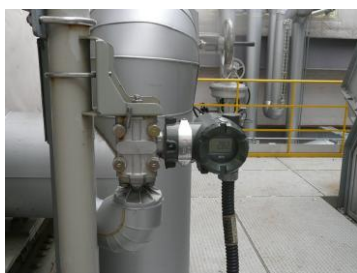
写真6 主蒸気ライン圧力計
