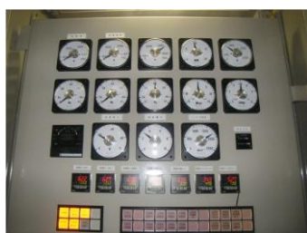
写真8 発電機監視盤
