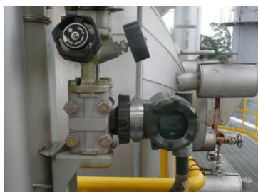
写真3 主蒸気ライン流量計
