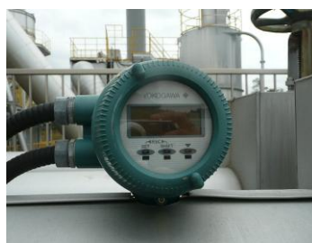
写真4 温水供給流量計
