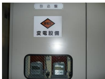
写真1 電力量計引込盤
