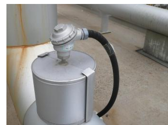
写真5 温水供給温度計
