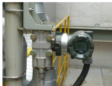
写真7 復水器入口蒸気圧力計
