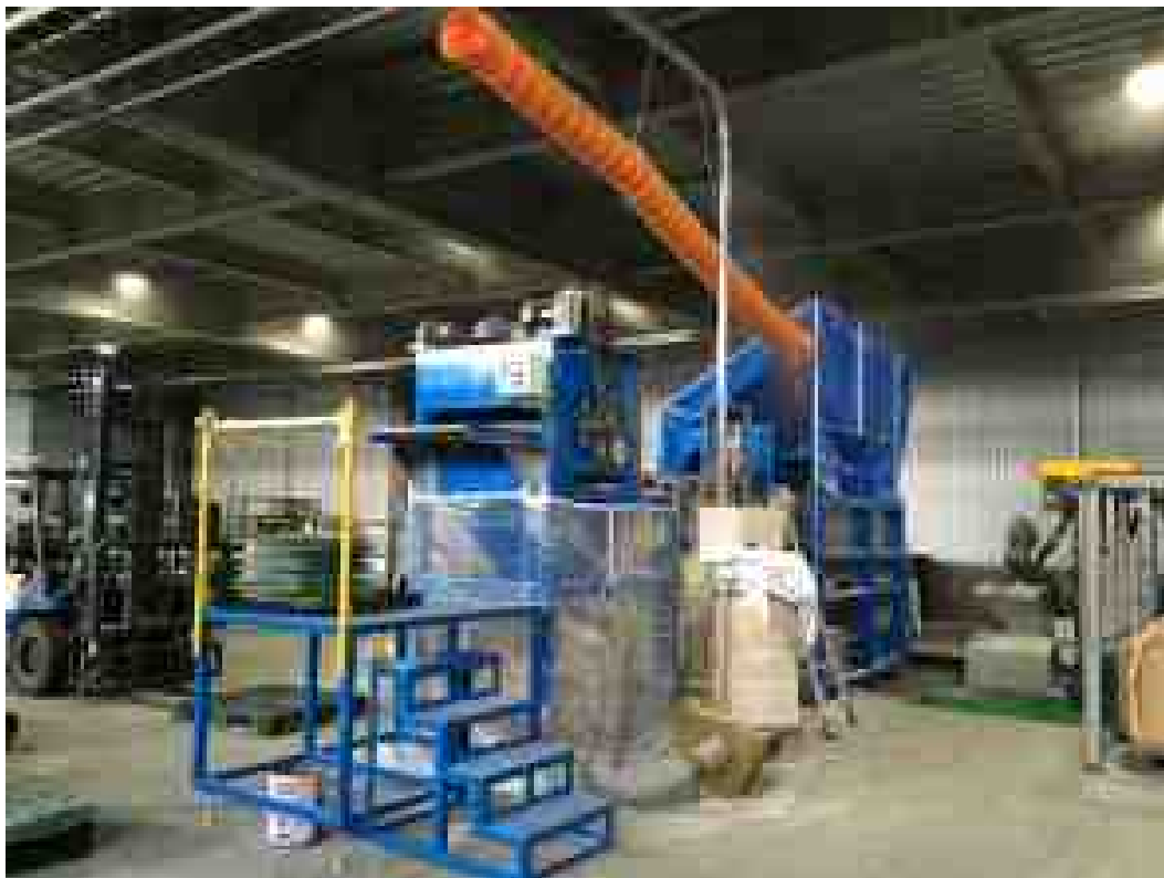
図 3-3 フロントガラス処理機（全景）
