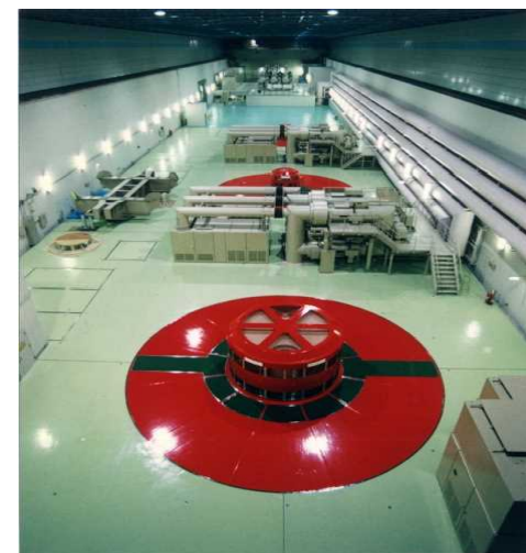
可変速揚水発電設備の外観
