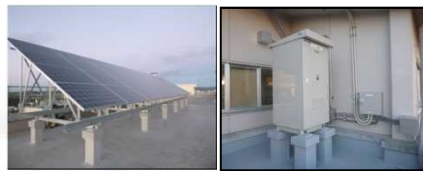
2011～2015 市内中核避難所に整備した PVと蓄電池（GND）
