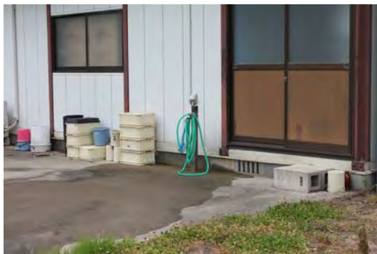
プレハブ前に設置されている洗い場
