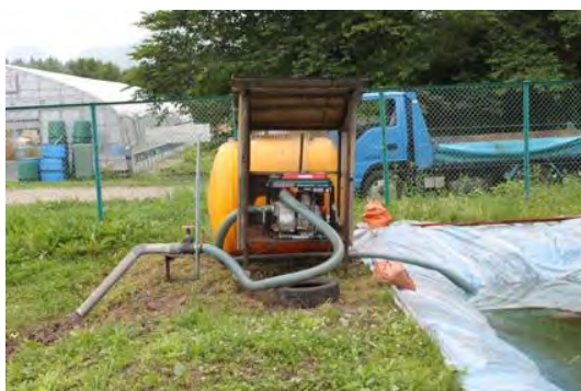
貯水槽から水田に水を供給するポンプ
