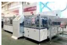
太陽光パネルリサイクル設備
