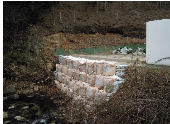
事前措置の例2: 河岸浸食箇所の応急補修措置として、大型土のう袋を配置する。
