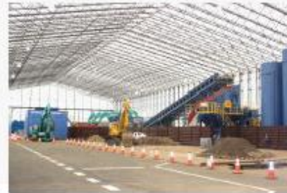
受入・分別施設（大熊工区）
