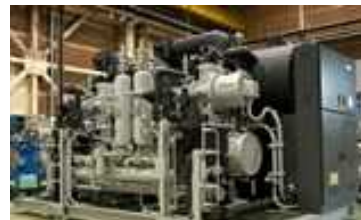
高効率冷凍機 (前川製作所)
