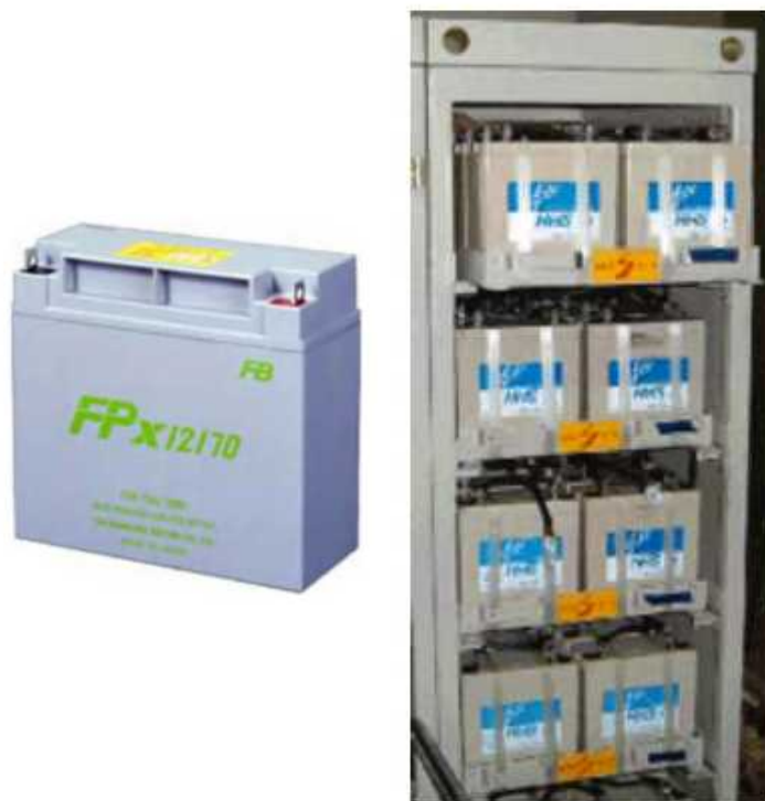
鉛バッテリーを使用
