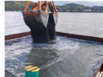
▲汚濁防止枠内へのHiビーズ投入 所定の厚さに覆砂するため、枠内を4分割し、投入回数を定め実施。(投入バケットのサイズ:4m3)
