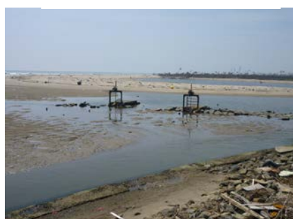
動流堤の被災状況(H23.8月)
