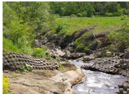
川底が削られた河川 (拡幅による流速低下策や河床安定のための の工作物設置を計画)
