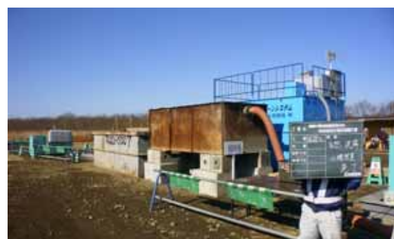
沈殿池・無機系凝集剤投入による濁水処理
