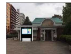
デジタルサイネージの設置
