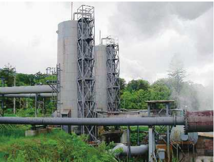
澄川地熱発電所（生産井の一部）
