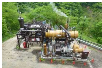
温泉熱によるバイナリー発電（磐梯朝日）
