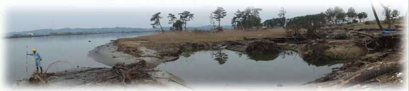
海岸防災林の被災状況及び復旧事業予定箇所(蛭塚地区)
