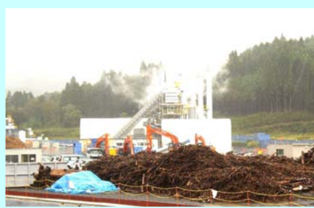
気仙沼ブロック南三陸処理区の仮設炉 （3基）（H24.9.15試運転開始）
