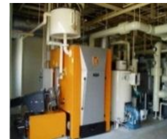
熱供給施設等での利用
