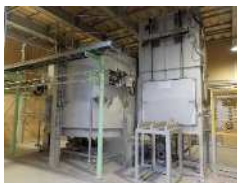
<Li-ion電池リサイクル設備>
