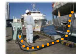
電力供給設備
