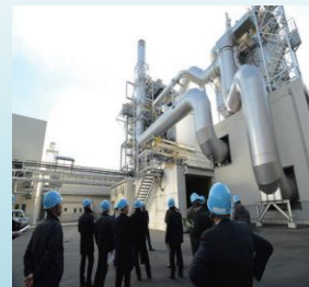
バイオマス発電所 (H29環境白書より)
