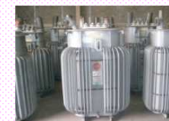
PCBが含まれる 高圧トランス
