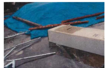
建物解体時にフロン類の回収がされず放置されている業務用エアコン
