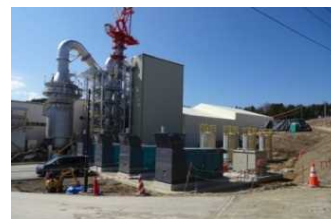
葛尾村の仮設焼却施設 （平成27年4月）
