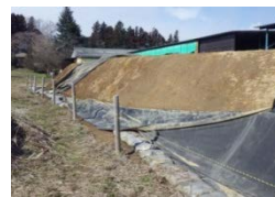
【強風により遮水シートが まくれ上がった様子】
