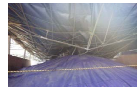
【大雪によりテントの 屋根が破損した様子】
