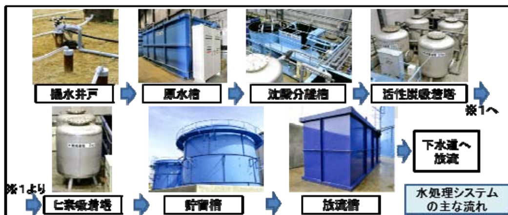
図3 高濃度汚染対策施設全景、揚水井戸、主要機器と処理の流れ
