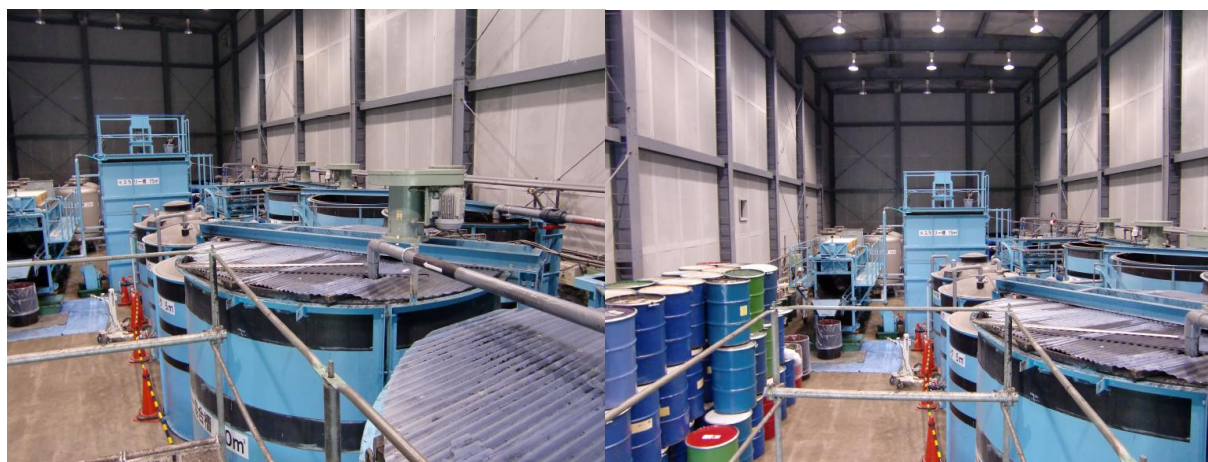
粉末活性炭により DPAA を吸着する活性炭反応槽。A 地区の原水濃度が低くなった場合には、活性炭吸着塔のみの運用も考慮し、フレキシブルな対応も可能なセッティングとしている。（写真上）
