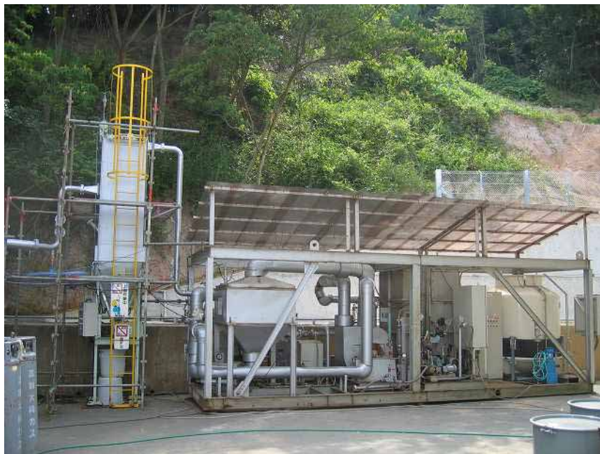
写真 2-2 装置写真（BF、排ガス処理設備）
