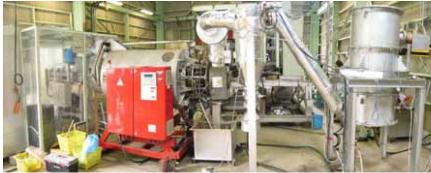
写真 2-1 装置写真（投入装置～二次燃焼炉）
