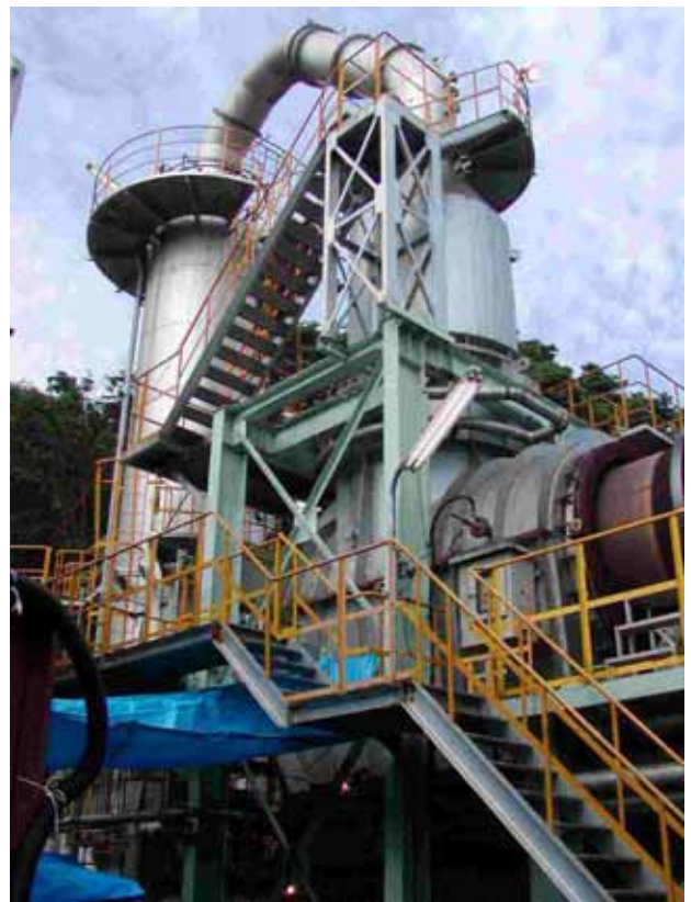
写真 3-2 装置写真 (二次燃焼炉、ガス冷却塔)
