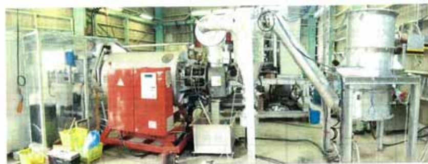
写真2-1 装置写真（投入装置～二次燃焼炉）
